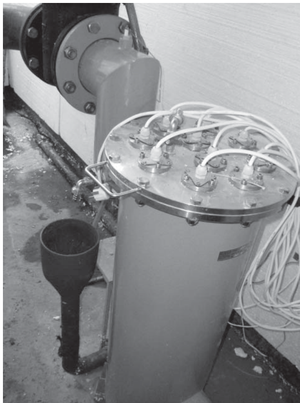
Установка ультрафиолетового обеззараживания (очистные сооружения с/п «Орбита»)
